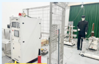
電気高圧実習室
